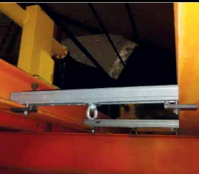
Die Befestigung von Konstruktionsteilen mit Klemmen stellt eine mögliche Schwachstelle im Brandschutz dar
