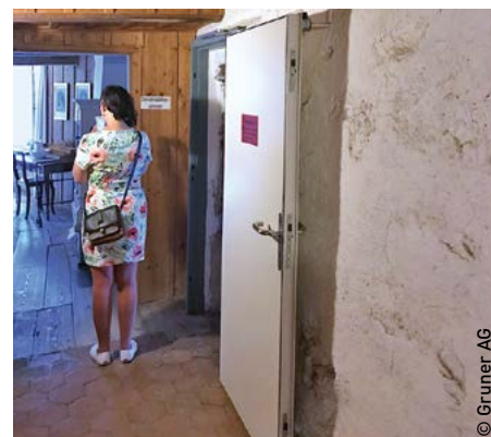
Brandabschnittsbildende Tür mit Magnetfeststeller in mittelalterlicher Mauer im Schloss Wildegg AG.
