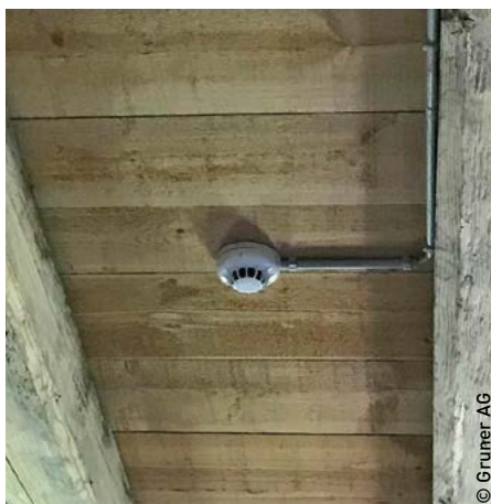
Brandmelder an Decke im Schloss.
