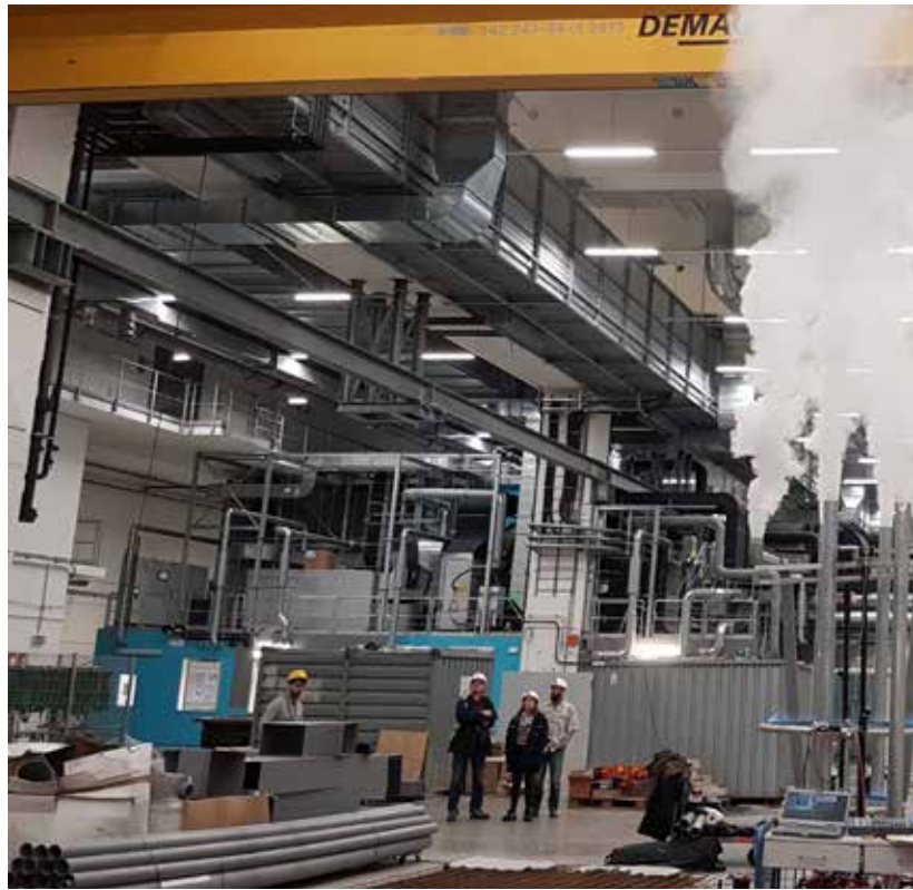
FEL Forschungsanlage, Hamburg
